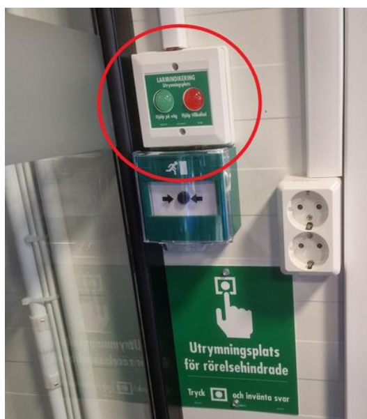
Figur 5.12 Exempel på utrymningsplats försedd med signallampa
