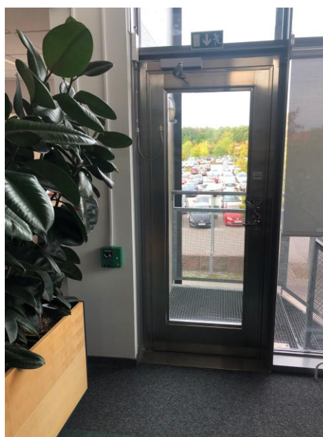
Figur 7.2 – utrymningsplats blockerad av kruka
