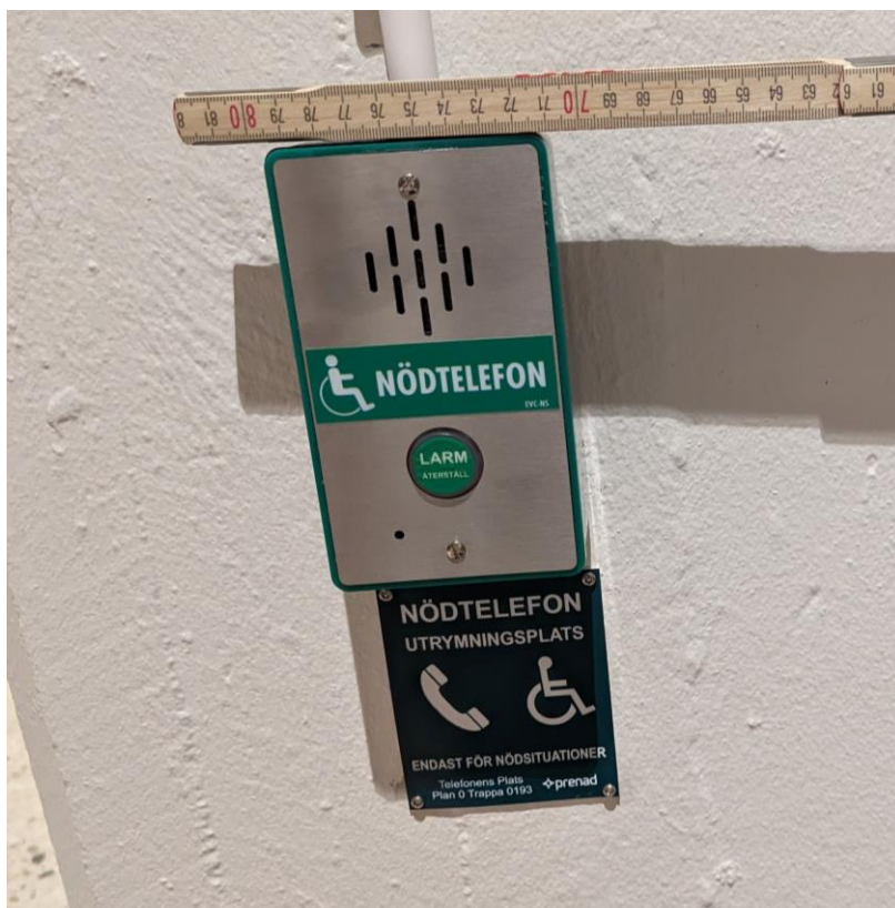
Figur 4.20 – Illustration över tvåvägskommunikationsutrustning och informationsskylt (ej enligt AFS 2020:1) tumstocken mäter avstånd till hinder
