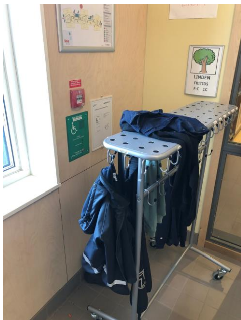
Figur 7.1 – utrymningsplats blockerad av lös inredning
